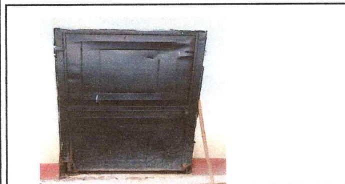
Foto 5: Sustrucción de puerta
